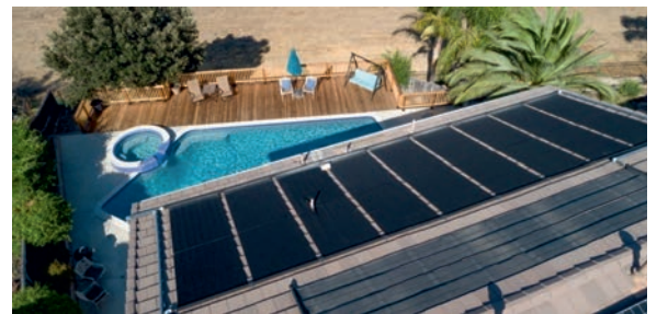
Рис. 4.17. Незасклений сонячний колектор для підігріву води
